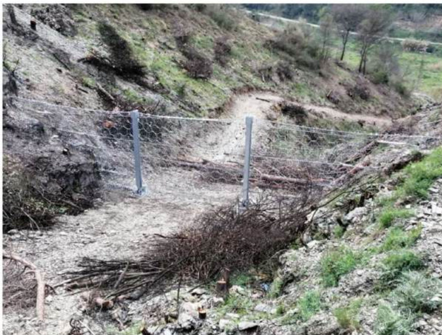
Figura 10. Barrera de protección contra debris flow a pie del terraplén de la pista forestal
